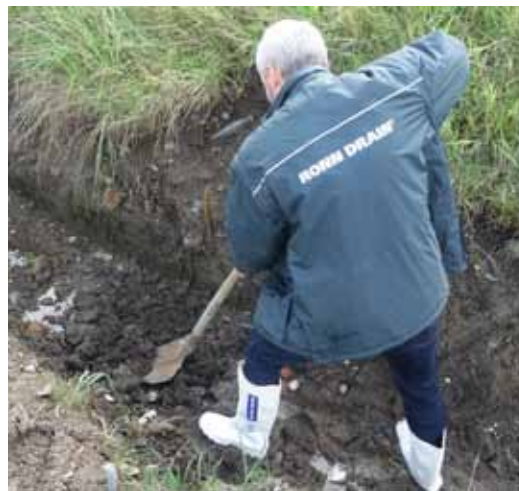
3 Vykopejte dostatečně velkou jámu a srovnajte dno. Při horším vsakovacím koeficientu zeminy lze dno vyplnit kamenivem frakce 4–16 mm v tloušťce 200 mm
